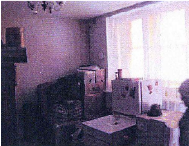
Фото № 11. Состояние внутренней отделки помещения
