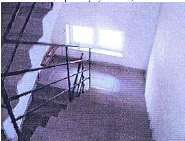
Фото № 9. Состояние подъезда
